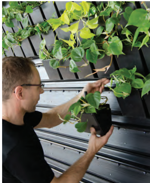
Die Natural Greenwalls® Pflanztöpfe werden in den Schienen eingeklickt.
